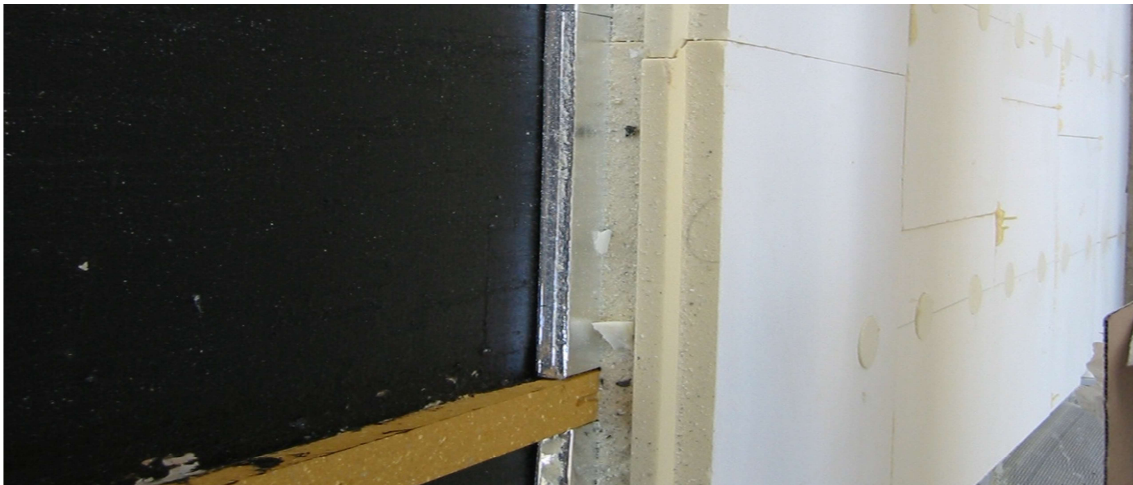
VIPs, überdeckt mit PUR-Dämmplatten mit diffusionsoffenen Deckschichten
